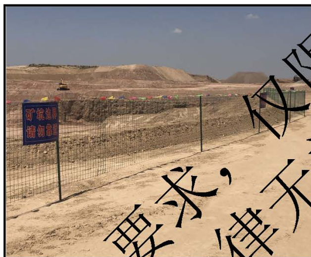
采场危险临边处防护网
