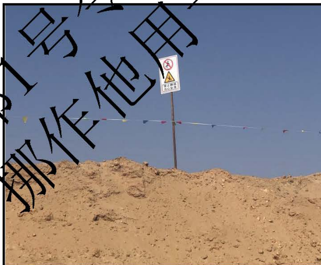
危险临边处警示标志
